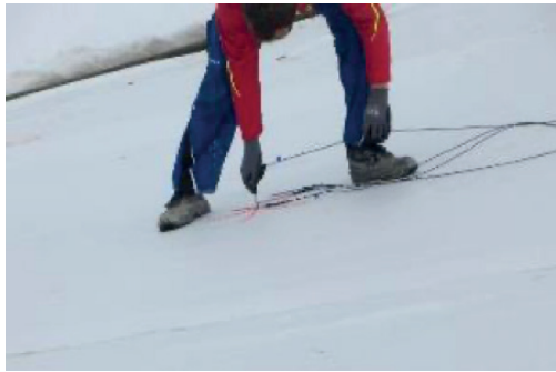
Figure 57: Leakage detection system for PTES in Høje Taastrup (Source: Gquadrat)
