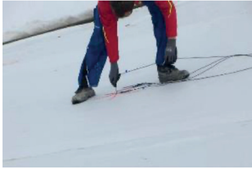
Abbildung 57: System zur Leckageerkennung für einen flachen Beckenspeicher in Høje Taastrup (Quelle: Gquadrat)
