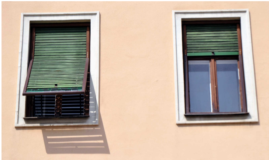
Abbildung 12: Versuchseinheit mit zwei zusätzlichen mit PV-ausgerüsteten Lamellen im ausgestellten Zustand (links)
