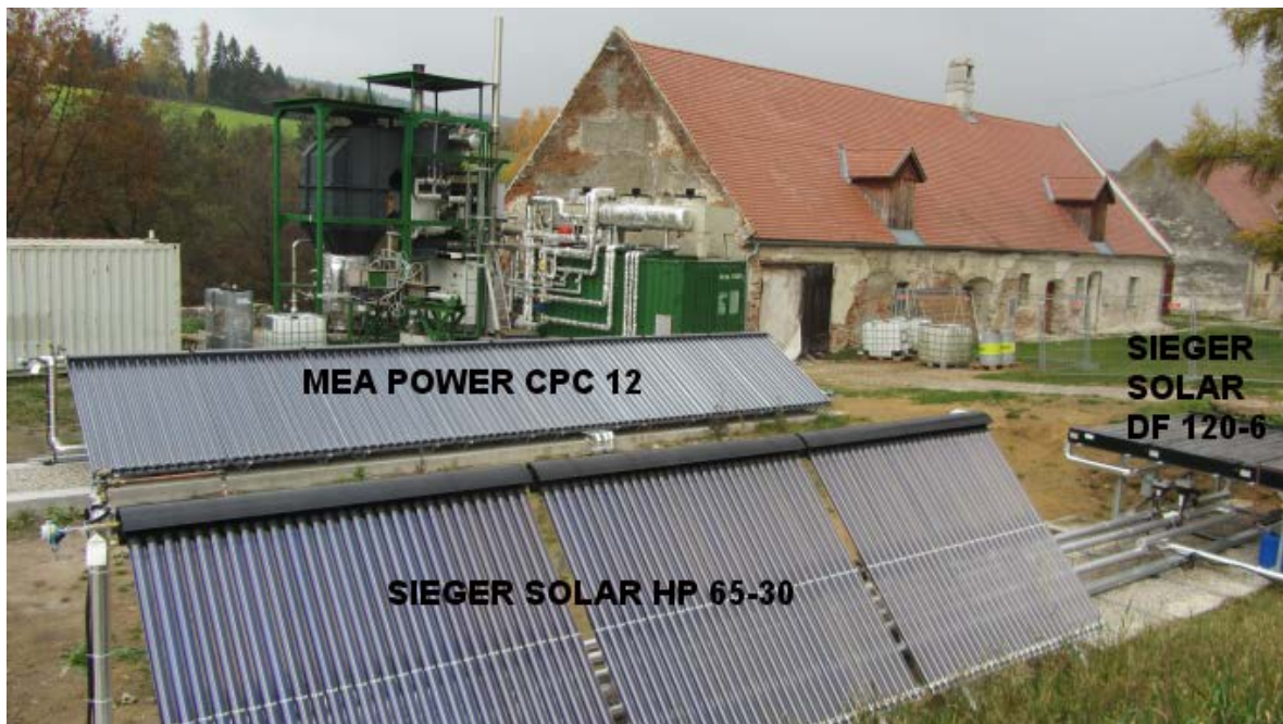
Abbildung 2.4: Örtliche Anordnung der am Standort Leiben aufgebauten Kollektorfelder
