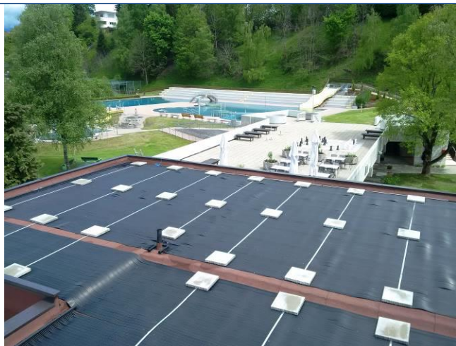
Abbildung 17: 470 m 2 Solar Absorber Anlage Freibad Schwaz (Quelle: AST)
