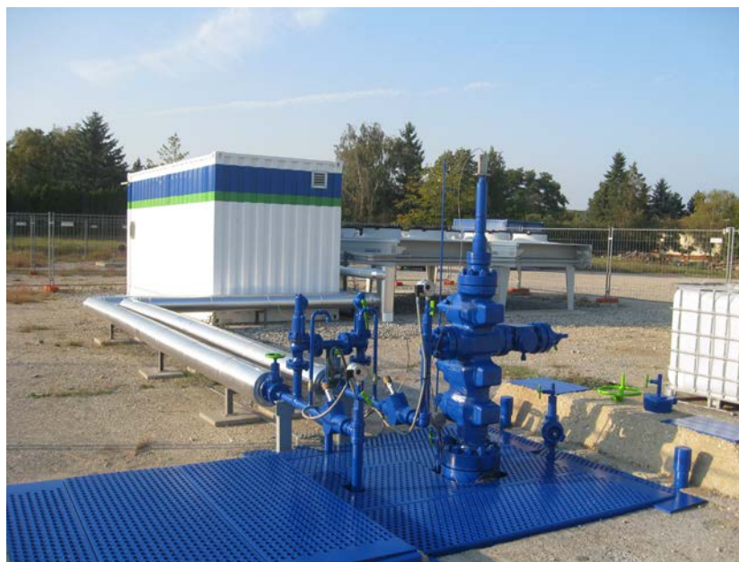
Abbildung 7: Geothermiecontainer, Eruptivkreuz und Rückkühler
