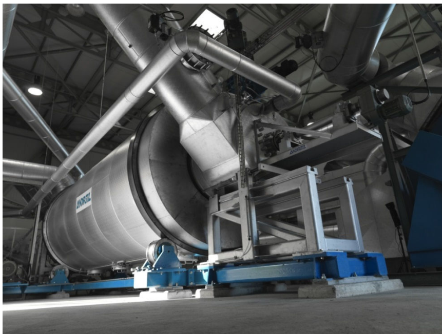
Abbildung 2 ACB Reaktor kurz nach Inbetriebnahme
