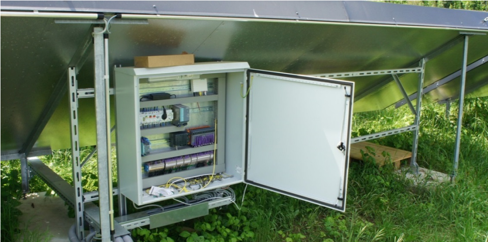
Abbildung 4: Schaltschrank mit Steuerung und Messdatenerfassung
