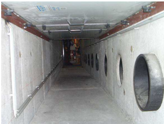
Abbildung 9.15: Blick in den Sammelschacht des Luft-EWT (Lüftungsgerät für Zuluft wenig wartungsfreundlich im Schacht hängend)
