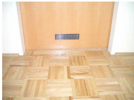
Abbildung 9.57: Überströmgitter in der Tür
