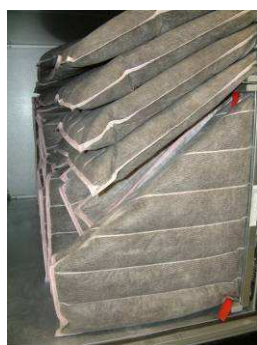
Abbildung 9.26: Hygienisch und strömungstechnisch ungünstige Einbaulage (oben) von nicht eigensteifen Taschenfiltern
