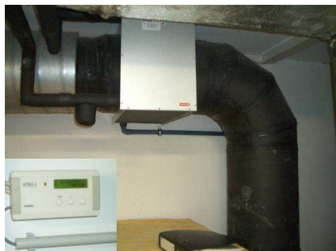
Abbildung 9.17: Grundwasser – Luft Wärmetauscher als Vereisungsschutz mit eigener Regelung
