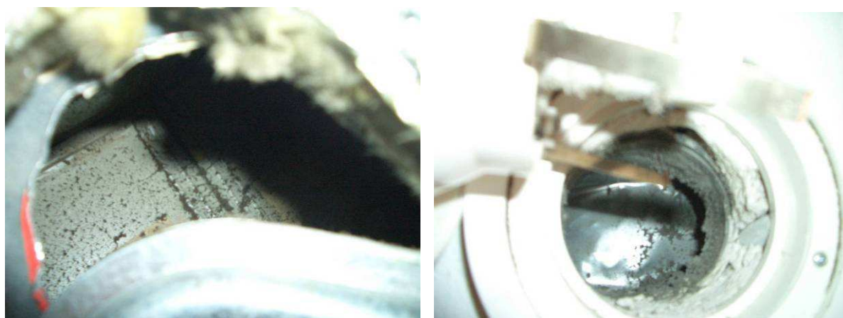
Abbildung 9.51 a und b: Verschmutzte Abluftleitungen bei einer Anlage außerhalb der Evaluierungsgruppe
