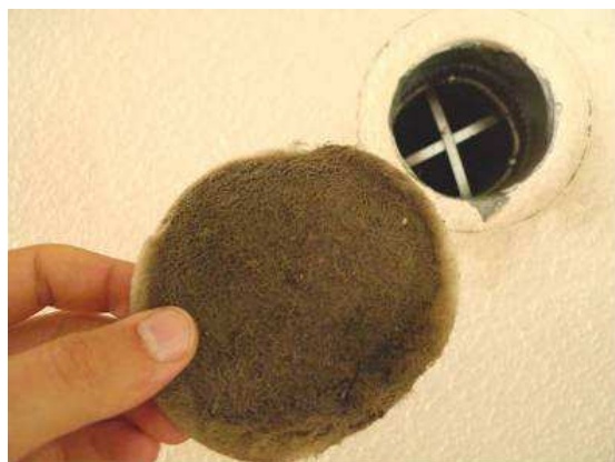
Abbildung 9.62: Ungeeignete Küchenabluftfilterung mit Textilfließ
