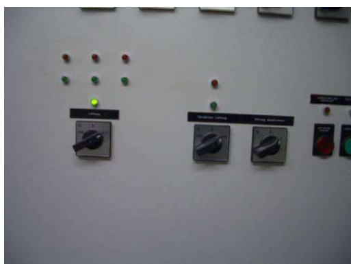
Abbildung 9.37: Einfacher Schaltkasten für eine Lüftungsanlage
